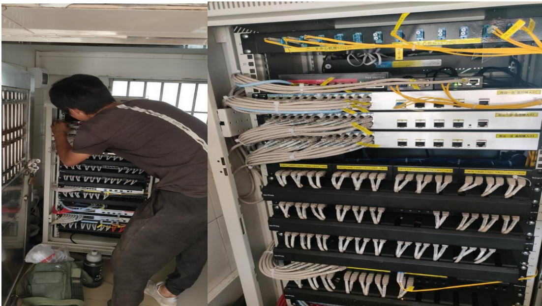
救治片区监控机柜理线
